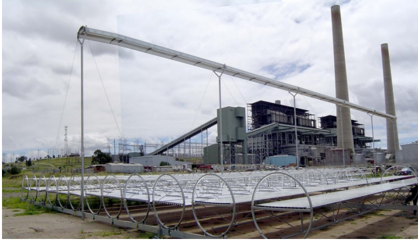
Prototipo CLF instalado en Liddell (Australia)
